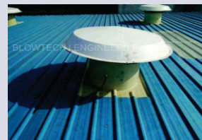
FRP Electrical Roof Exhaust Fan
